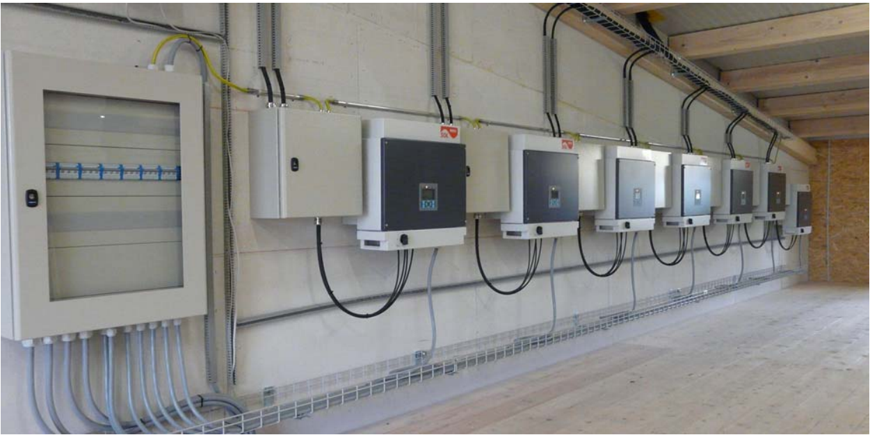
Refusol Wechselrichter im Bürogebäude...
