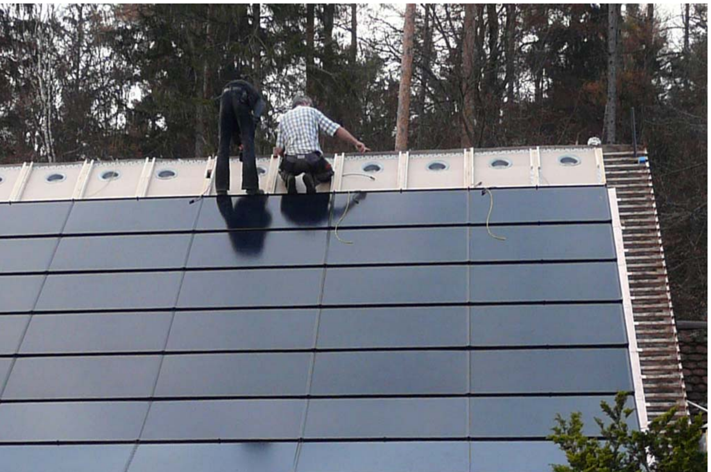
gut sichtbar die Ansaugöffnungen am oberen Rand
